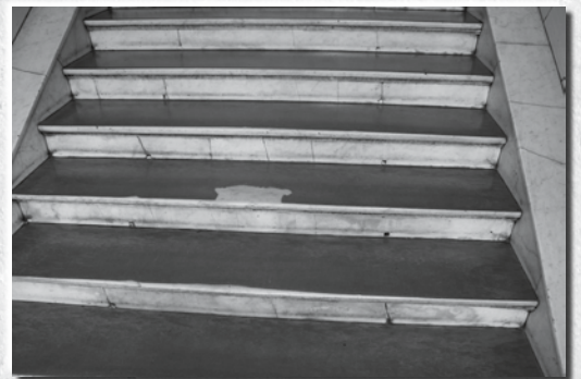
Nun harret das Gebäude seiner Innenrenovierung, die dringend notwendig ist, sieht man dort noch alte DDR-typische Waschbecken, zerstörte Fußböden, alte Treppen...
